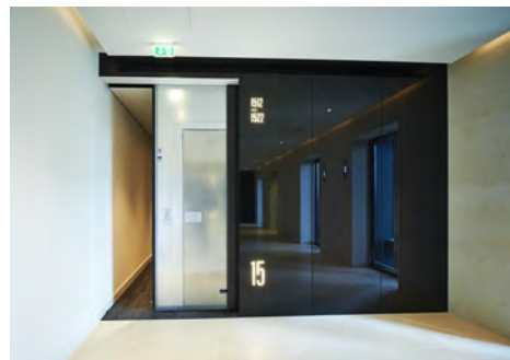
Bild 4: Feuerschutz-Schiebetor im hochwertigen Objektbereich
