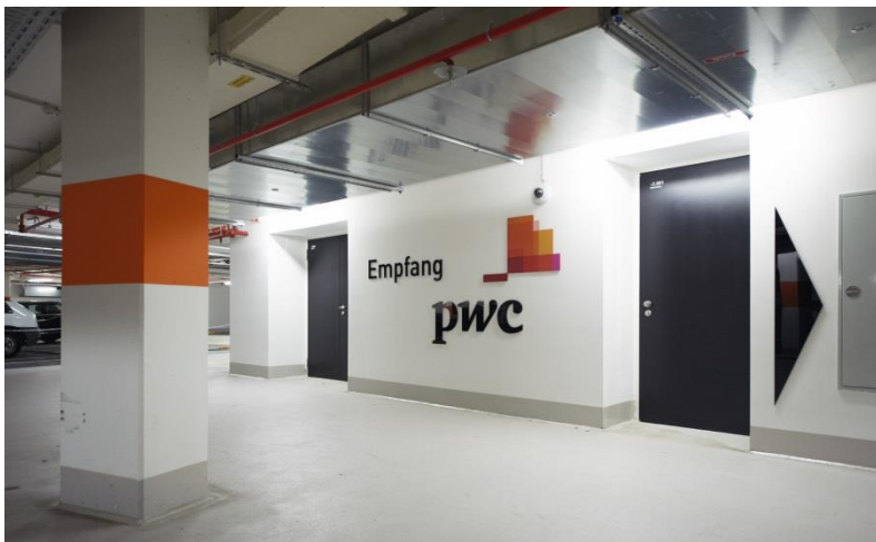
Bild 3: EI 2 30 Feuerschutztür STS im Übergang von Tiefgarage zum Treppenflur.
