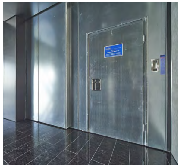
Bild 4: ...und geschlossen bei Brandfall
