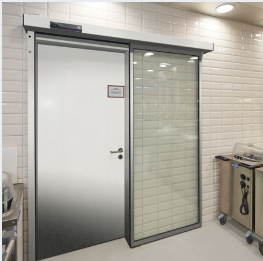
Nachtbetrieb mit geschlossener Feuerschutztür
